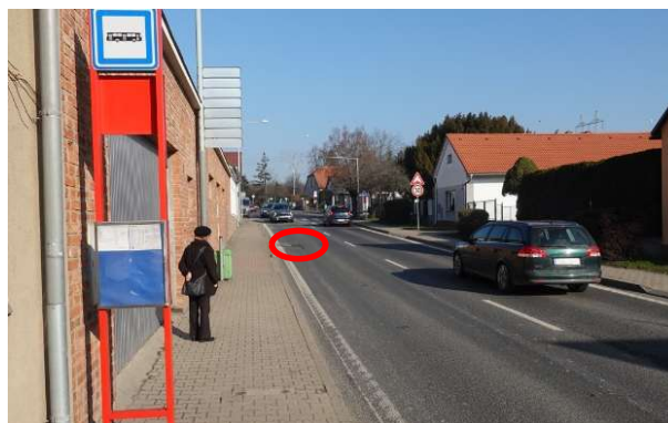
Obrázek 175 – Vzdálený pohled na výtluk v blízkosti zastávky „Šeberov“.
