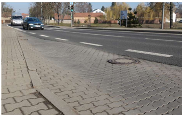
Obrázek 172 – Pohled na propad povrchu v místě autobusové zastávky „V Ladech“.
