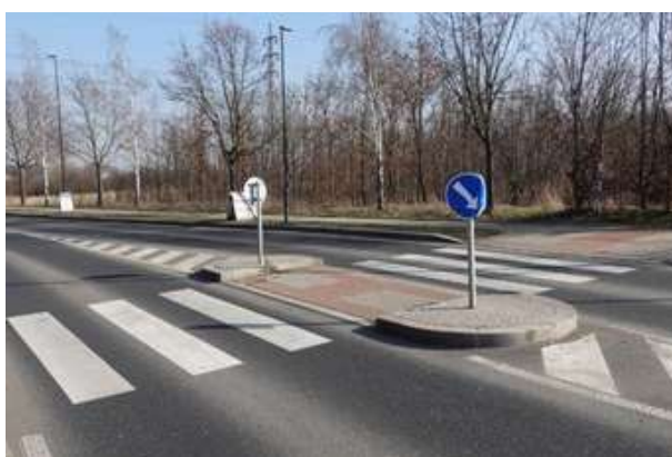
Obrázek 146 – Fyzicky poškozené SDZ C 4a poblíž restaurace „BUFÁČ“ v MK K Hrnčířům.
