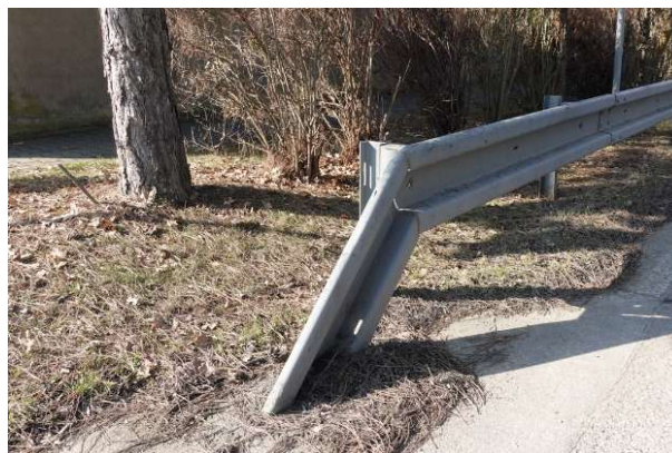
Obrázek 157 – Ukázka neadekvátního výškového náběhu svodidla.
