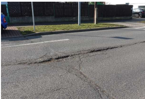
Obrázek 170 – Pohled na výtluky a trhliny v místě západního ramene MK Labeškám.
