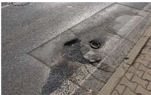
Obrázek 174 – Detailní pohled na výtluk poblíž autobusové zastávky „Šeberov“.
