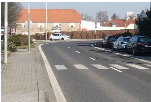
Obrázek 86 – Absence signálního a varovného pásu v místě přechodu pro chodce v MK K Hrnčířům.
