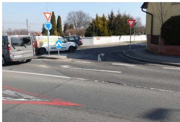
Obrázek 171 – Další ukázka poškozeného povrchu vozovky v místě jižního ramene OK.
